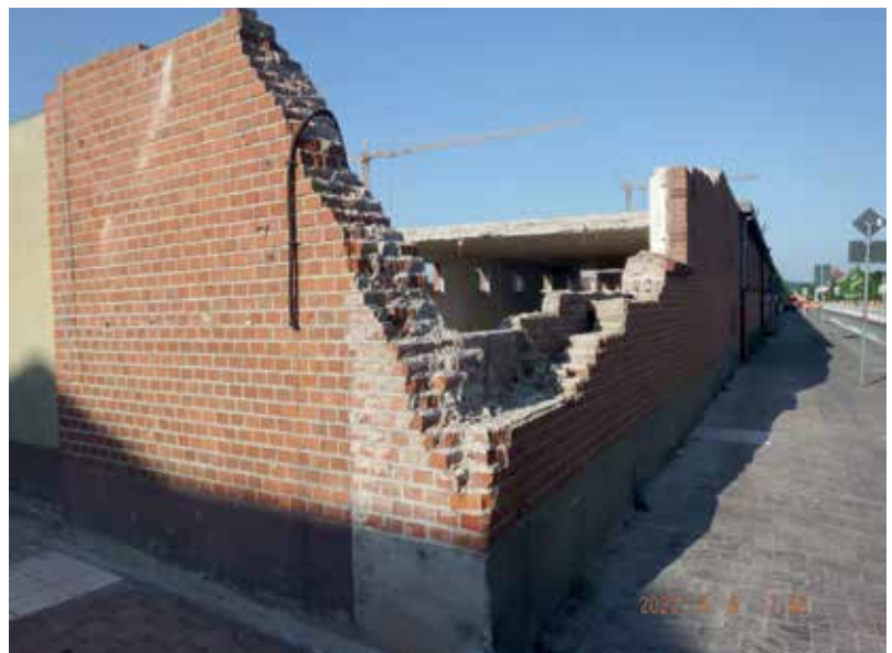
„Sanierung“ à la P&P-Gruppe
