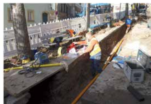
Bild 3: Im Leitungsgraben wurden alle vorhandenen Wurzeln bis 1 m Tiefe abgegraben. Schutzmaßnahmen gemäß 18920 wurden nicht berücksichtigt, da eine Fällung der Baumallee vorgesehen war.
